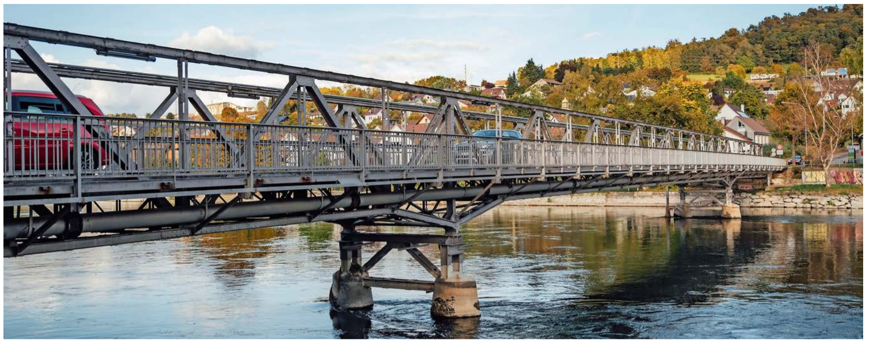
101 Jahre alt und mehrfach saniert, da korrosionsanfällig: der Eiserne Steg, der Flurlingen (rechts) mit Neuhausen verbindet.
